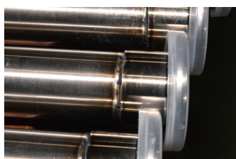
図4：ヘリウム回収管の溶接部
